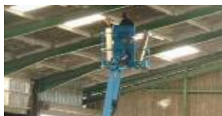
Changement des néons à l’aide d’une nacelle à la ferme de Bernussou
