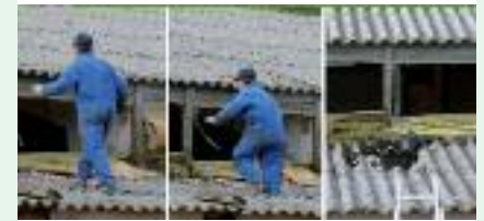
Plaques en fibrociment : ça passe ...ou ça casse !
