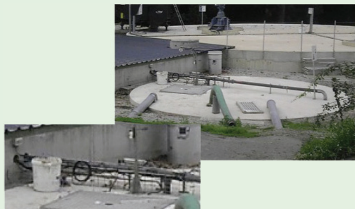
◀ Cuve de réception de lisier avec détecteur de niveau.
